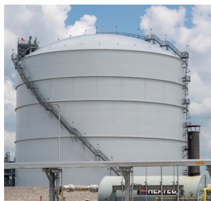
LNG PEAK SHAVING AMMONIA LIN / LOX
